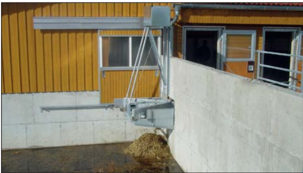
Ausleger und Antriebswinde an tiefer liegender Dunglege
